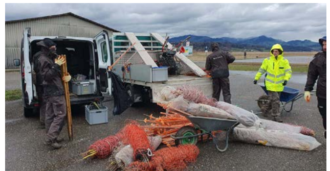
Kilometer um Kilometer werden Zäune im Nuoler Ried und Frauenwinkel als Schutzmassnahme aufgestellt.
