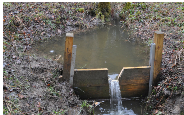
Beispiel einer Stautafel zur Regulierung des Wasserhaushalts im Flachmoor.
