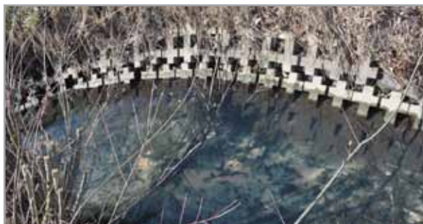
Bild 1: Wegen dem fehlenden Schilfgürtel fressen sich die Wellen landeinwärts. Bild 2: vorne das erodierte Ufer, hinten die im Projekt Pfäffiker Ried, Teil-1 bereits umgesetzte Seeufersanierung. Bild 3: Nächstes Jahr bekommt der Riethofbach dank dem Projekt Pfäffiker Ried, Teil-2 wieder ein natürliches Bachbett.
