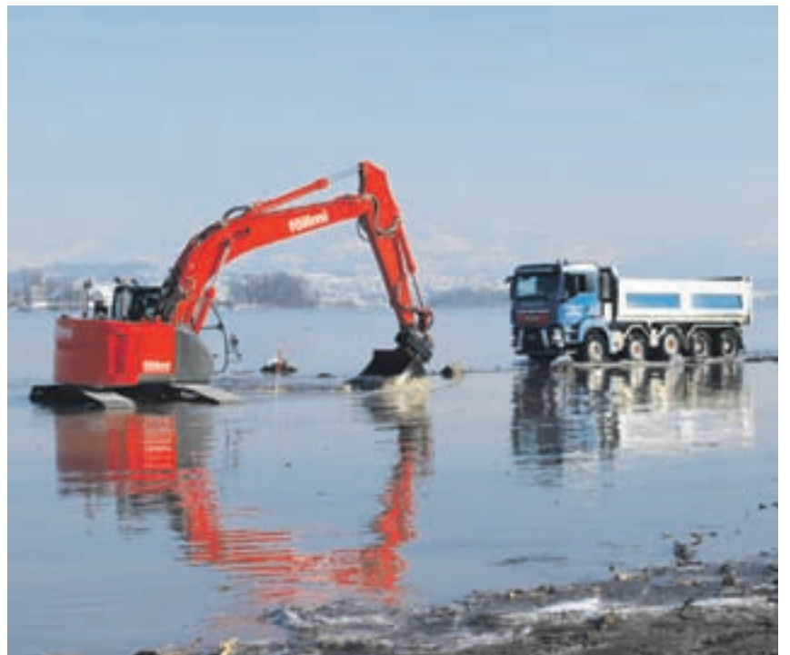
Es war eine spektakuläre Bauzeit: Über eine abenteuerliche Fahrpiste wurden Steine und Kies für Riffschüttungen geliefert.
